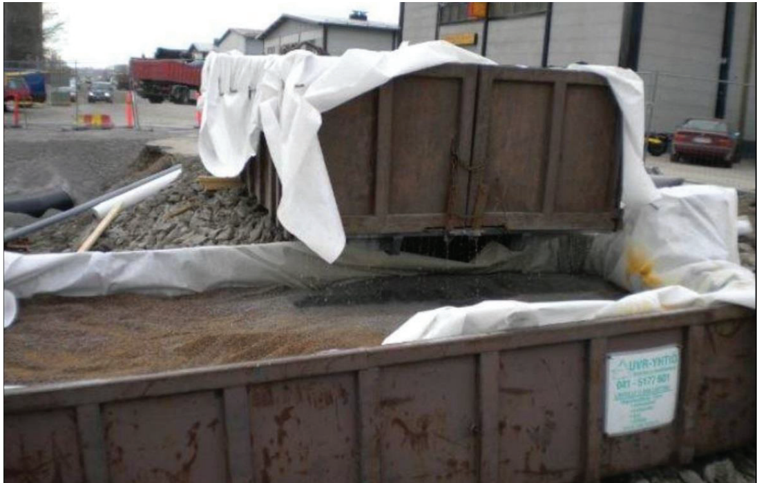
Kuva 35. Vaihtolavalla toteutettu hulevesien suodatus.
