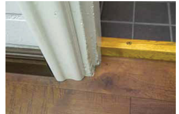
Viime vuosikymmeninä uusittuja listoja, joiden muoto on erilainen kuin alkuperäisten listojen.
