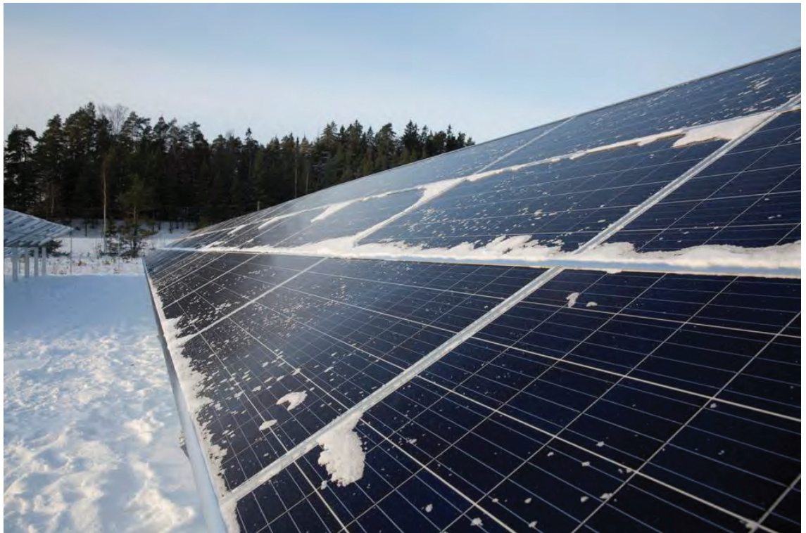
Kuva 2-16 Aurinkopaneeleja lumisissa olosuhteissa. (Kuva: Keravan Energia)
