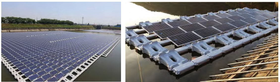
Kuva 2-12 Esimerkkejä kelluville perustoille asennetuista aurinkopaneeleista. (Kuvat: Ciel&Terre)
