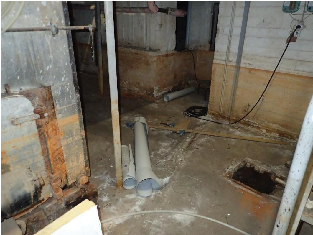
Kuva 6. Kattilahuoneen seinissä näkyy raja, missä todennäköisesti veden pinta on ollut.
