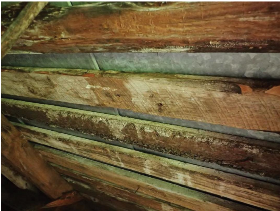
Kuva 11. Yläpohjassa on paljon kosteuden aiheuttamia vaurioita.
