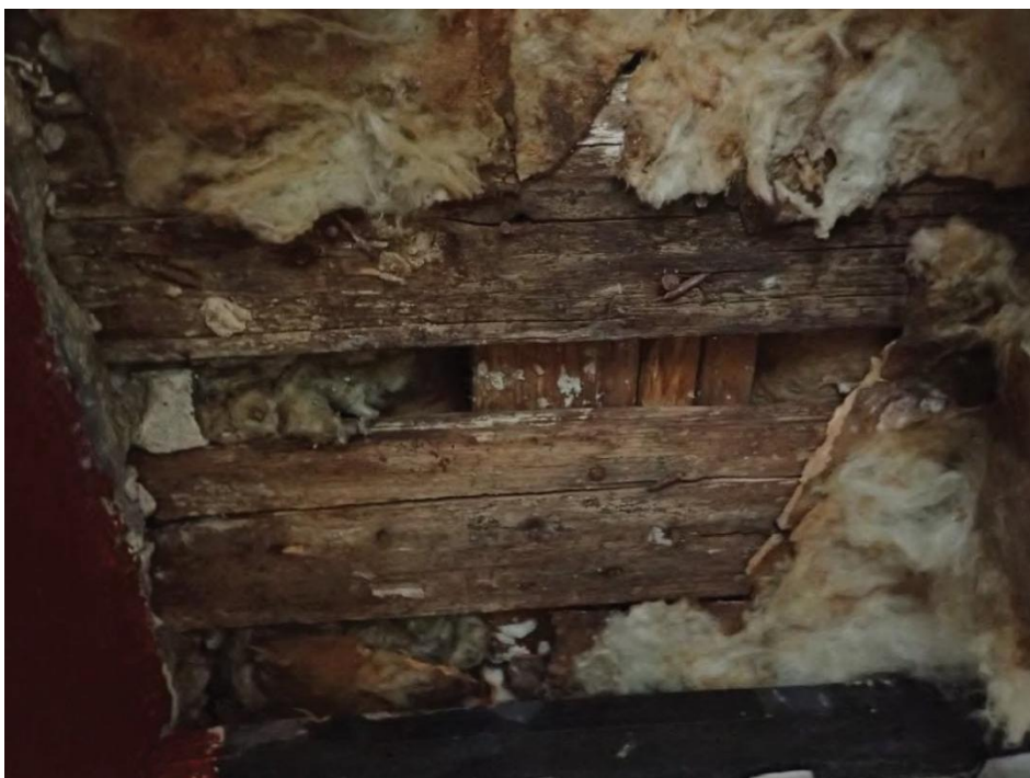
Kuva 12. Vuodot ovat pilanneet koko yläpohjarakenteen.
