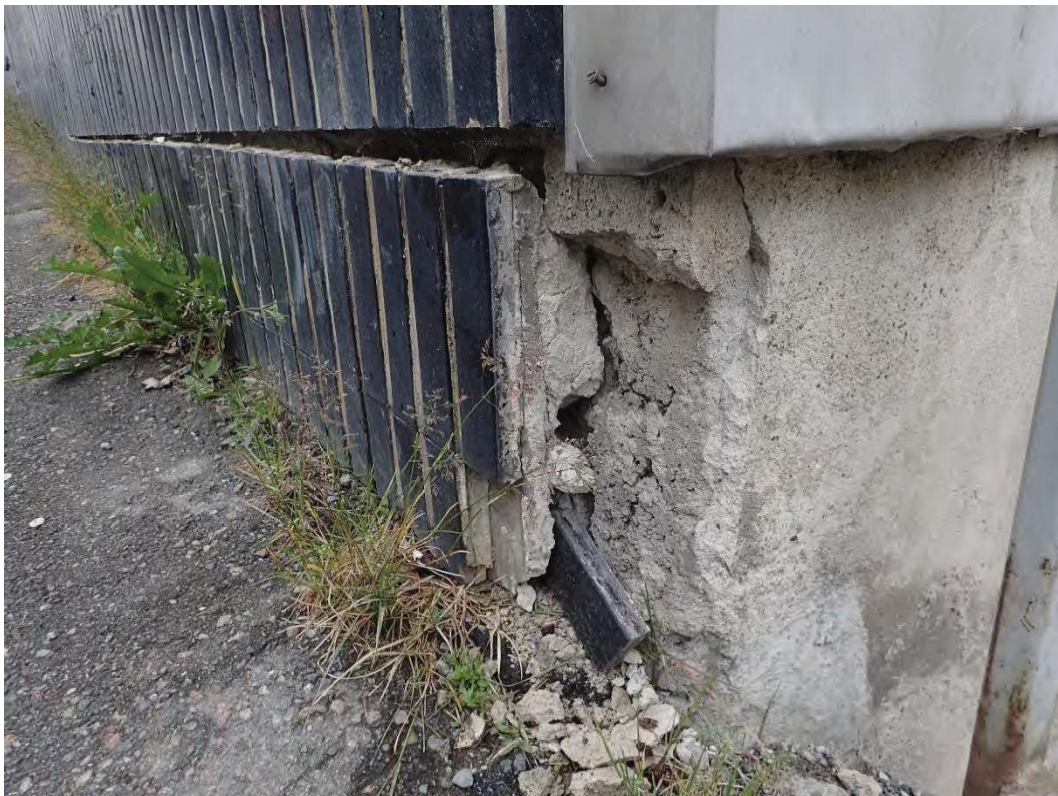
Kuva 3. Kellarin betoniseinä on huonossa kunnossa.
