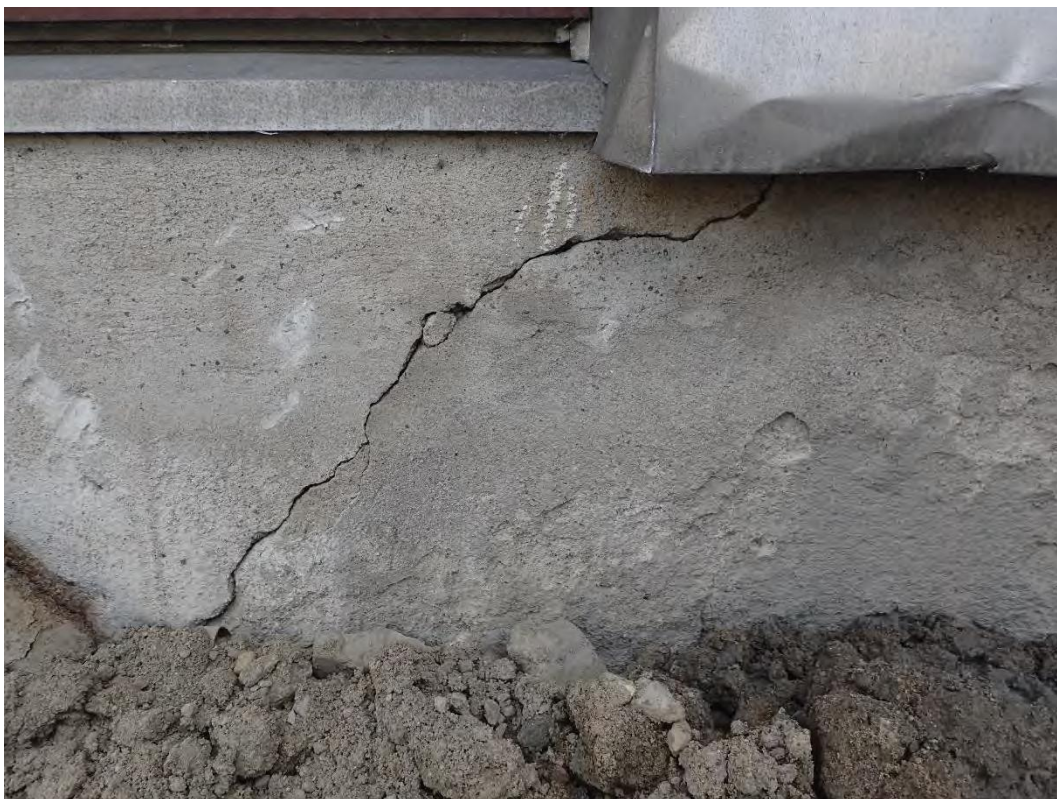
Kuva 4. Halkeama kellarin seinässä sisäpihalla.
