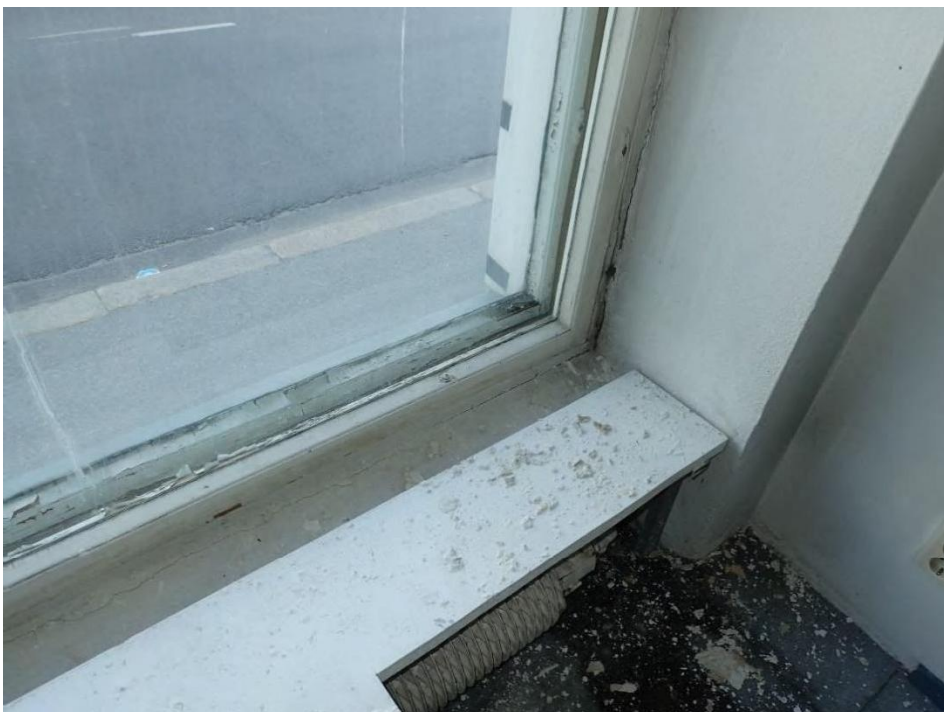
Kuva 15. Ikkuna sisäpuolelta. Kuvassa näkyy myös vesivuotojälkiä patterin luona.
