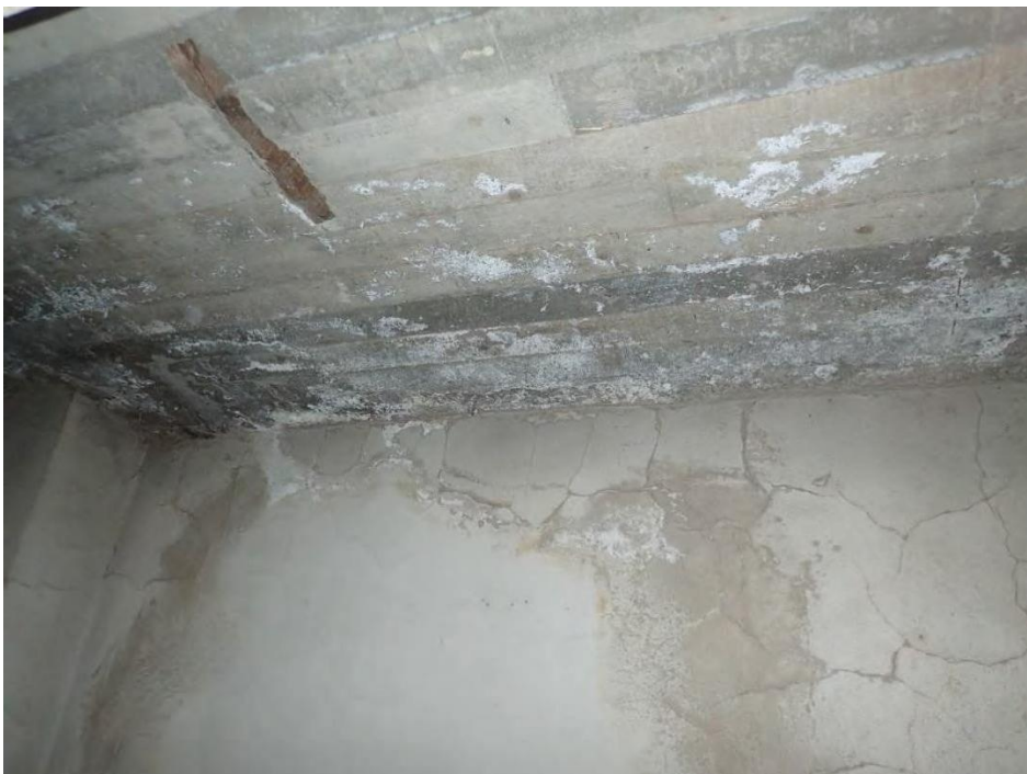
Kuva 10. Kosteuden aiheuttamia jälkiä yläpohjan ylälaattapalkistossa.
