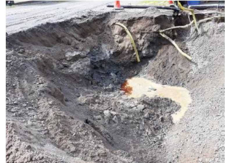
Kuva 13. Öljysäiliö on vuotanut maaperään. Kuva: Envineer Oy
