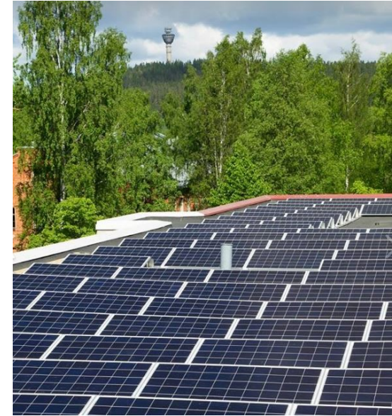
Kuva 8. Kuopion valtuustotalon aurinkovoimala otettiin käyttöön heinäkuussa 2018. Voimala tuottaa n. 8 % talon vuosittaisesta sähkön tarpeesta. Kuva: Vicente Serra, Kuopion kaupunki
