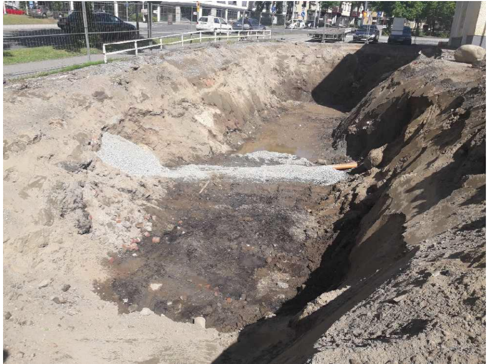
Kuva 7. Vanhan säiliöalueen kaivanto kuvattuna lännestä. Vaalea täyttö kaivannon pohjassa on uusitun jätevesiviemäriinjan kohdalla.
