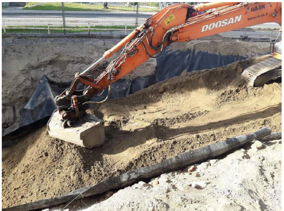
Kuva 8. Vanhan mittarikentän kaivannon täyttö aloitettiin itäpäästä. HDPE-kalvo asennettiin kaivannon pohjalle ja seinämiin.
