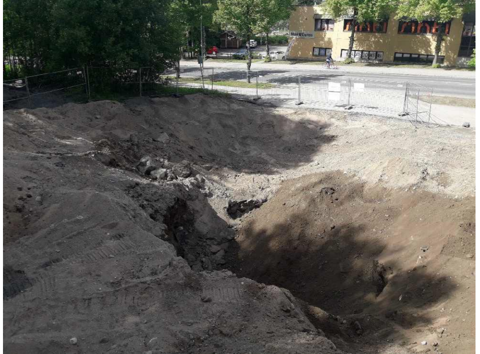
Kuva 3. Kiinteistön länsilaidan säiliökaivannot, Neljän säiliön kaivanto jo lähes täytetty. Polttoöljysäiliön kaivanto kuvan etualalla vielä auki. Kuvattu etelästä.
