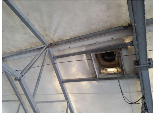
Kuva 9: Pohjoinen poistopuhallin (itä kattolape)
